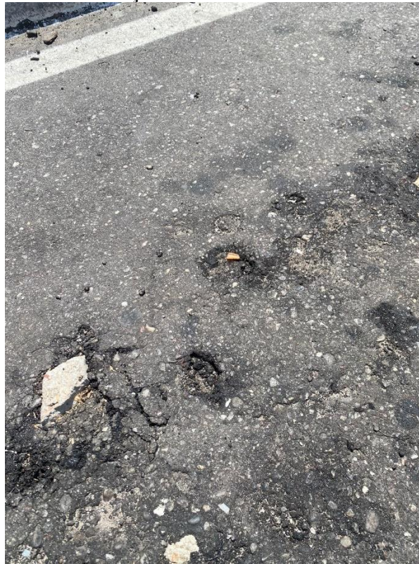
Figura 9 - Deformações asfálticas na orla de Ananindeua.
